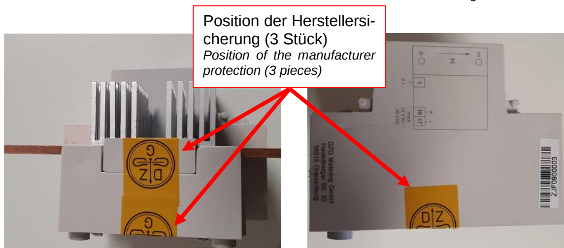
Abbildung / figure 2: Position der Herstellersicherungen am Gleichstromzähler „GSH01“ / Position of the manufacturer protection on the DC meter “GSH01”
